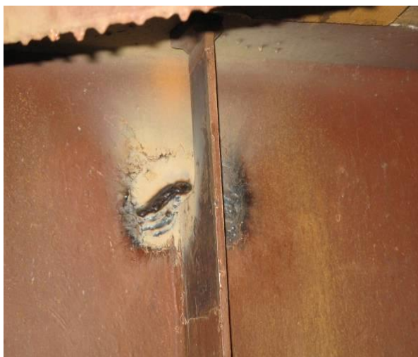
Рисунок 5.3. Трещина после заваривания
