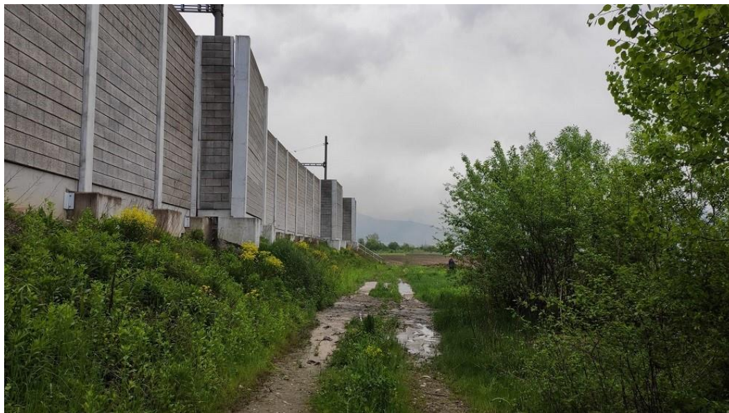
Рисунок 5. Наклон шумозащитных колонн
