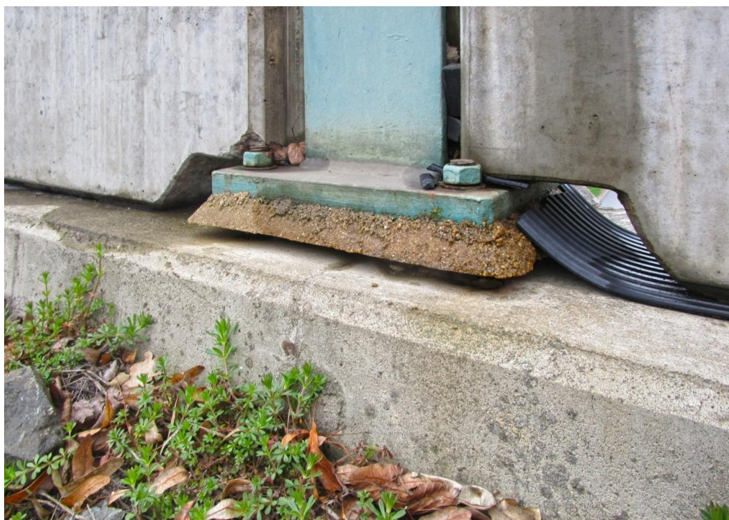
Рисунок 6. Недостаточно закрепленная стойка с фундаментной панелью.
