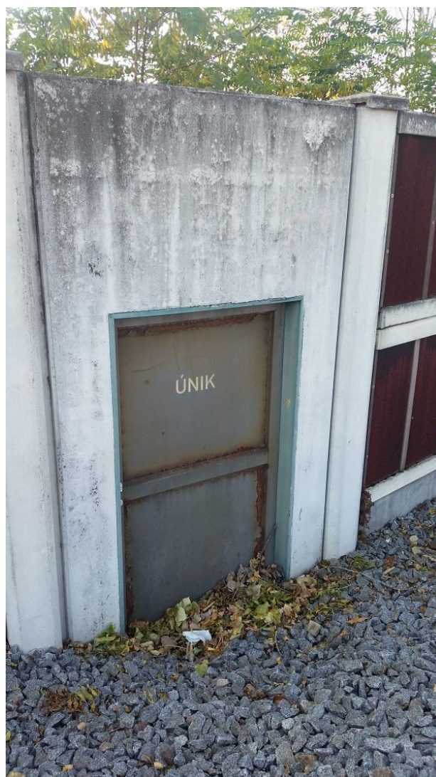
Рисунок 8. Недоступный эвакуационный выход
