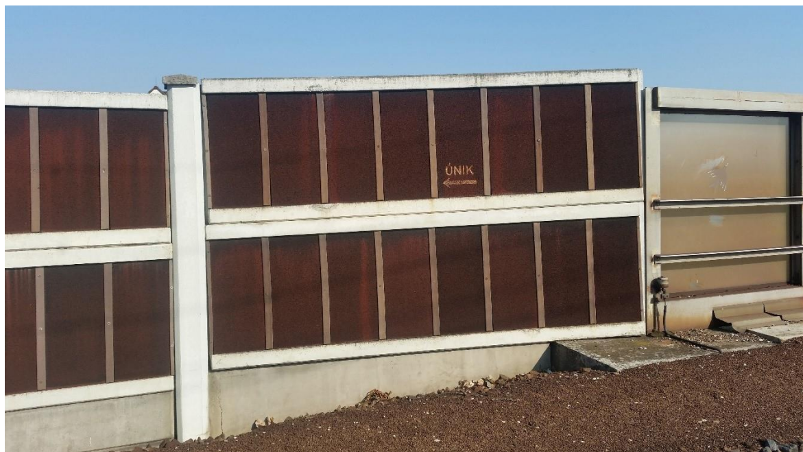
Рисунок 7. Наклон стены из-за неудачно расположенных свай в переходной зоне моста
