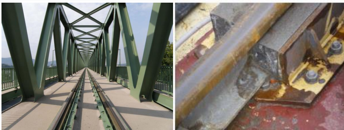
Рис. 28. Упругое прикрепление рельса в продольном стальном желобе на ортотропной несущей плите (система EDILON ERS) на железнодорожном мосту через реку Дунай в Будапеште. Скорость движения поездов 160 км/ч.
