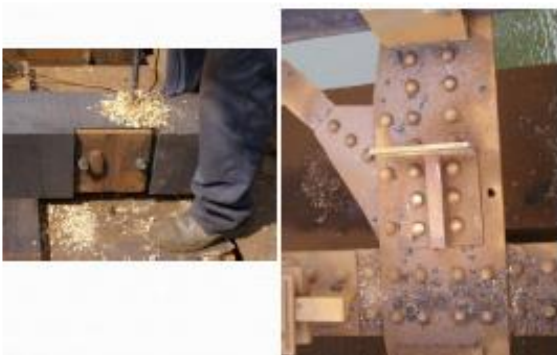
Рис. 5. Мостовое полотно на деревянных мостовых брусках, прикрепленных к продольной балке моста центрирующими элементами и горизонтальными болтами.
