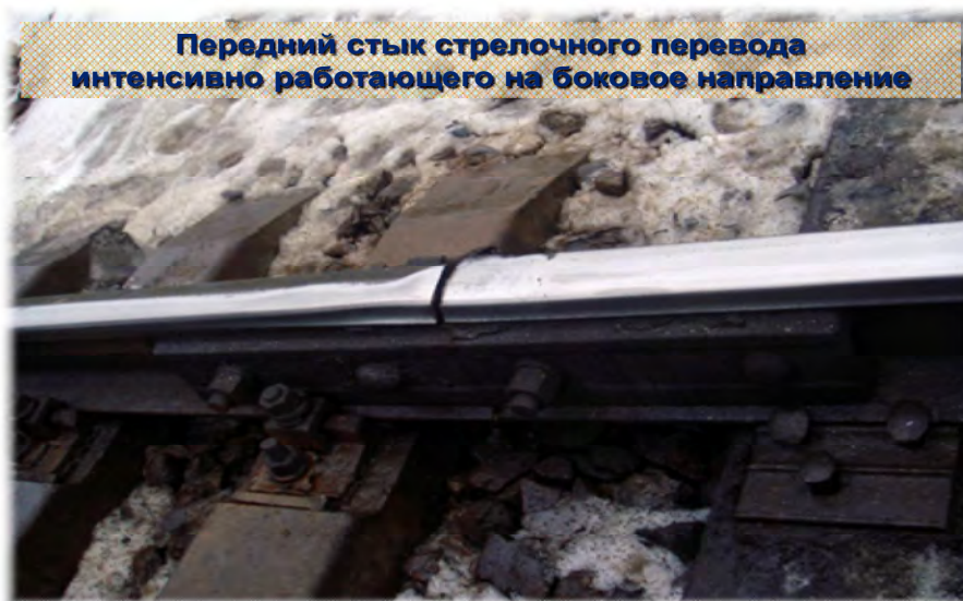
Рисунок 4.1 - Состояние переднего стыка рамного рельса до установки контррельса-протектора
