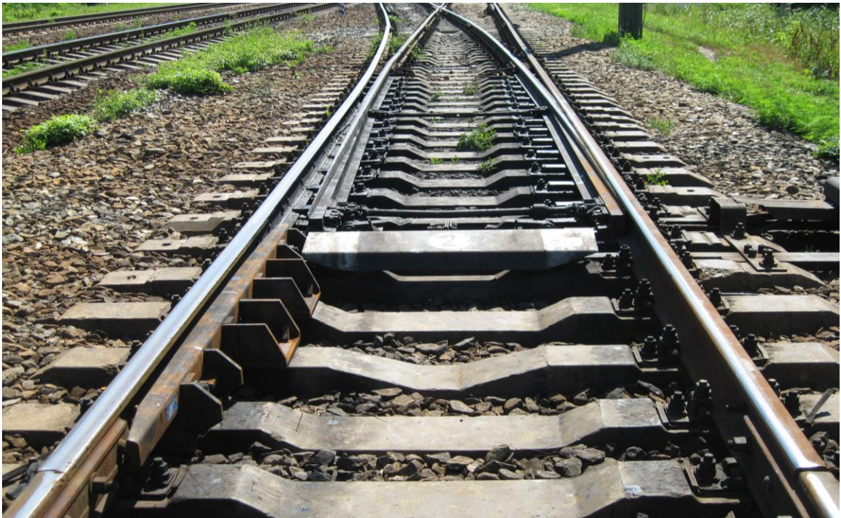
Фото 1. Контррельсы протекторы, устанавливаемые в переднем вылете рамного рельса
