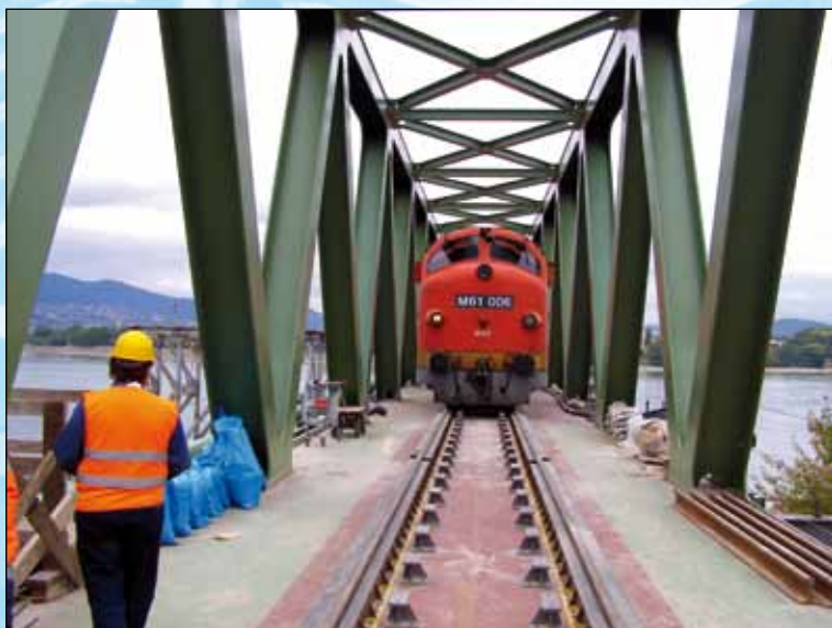
Открытие движения по реконструированному Северному железнодорожному мосту на линии Эстергом – Будапешт (Венгрия)
