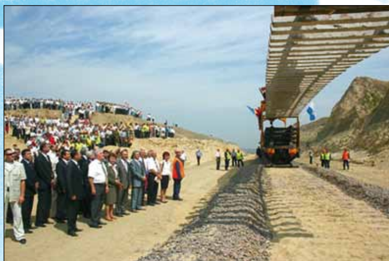
卡古尔—久尔久列什特（摩尔多瓦共和国）铁路工程正在铺设最后一组轨排
